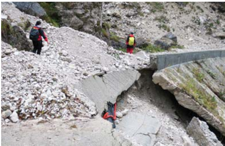
Frane e cedimenti stradali in Val Cimoliana (foto di Ivan Da Rios).
